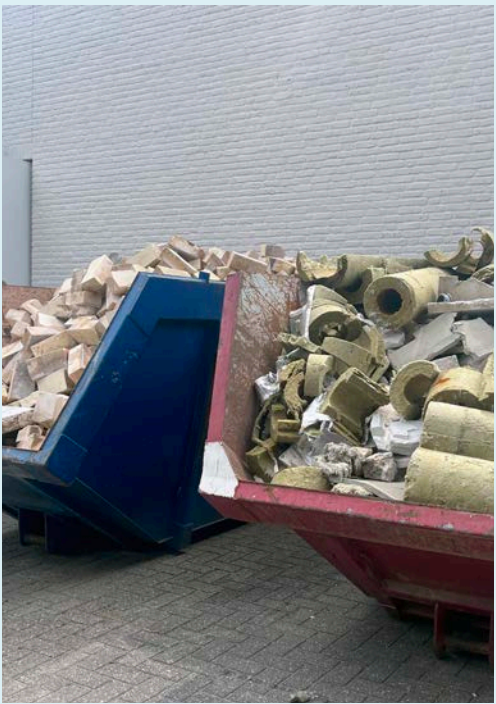
De oude rookgaskanalen in de container.
